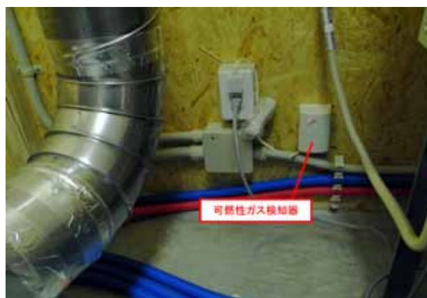
可燃性ガス検知器（電気室内）
