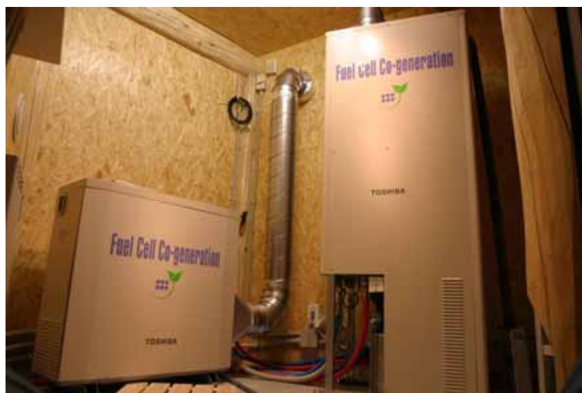
電気室内の燃料電池ユニット（左） 給湯ユニット（右）
