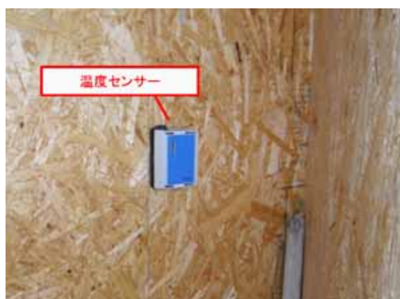
温度センサー（電気室内）
